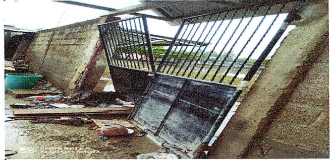
FOTO NO. 2 PORTÓN DAÑADA DE LA PARTE ATRÁS DEL ESTABLECIMIENTO.
