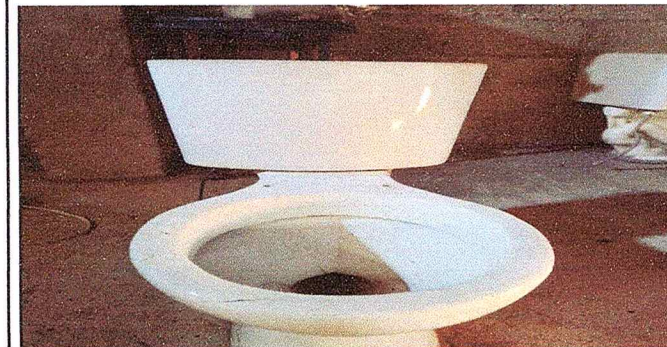
FOTO No. 11 UNO DE LAS MEJORAR QUE SE CONSIDERA INDISPENSABLE PARA UN BUEN AMBIENTE QUE DEBE DE EXISTIR PARA LOS ALUMNOS ES EL CAMBIO DE INODOROS,
