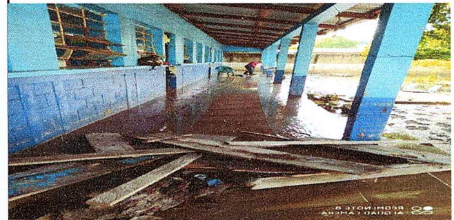
FOTO No. 4 LAS VENTANAS FRONTALES DEL LAS AULAS NO CUENTAN CON VALCONES PARA MAYOR SEGURIDAD DEL ESUTIANTADO Y LOS ESCRITORIOS.
