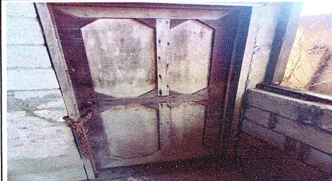
FOTO No. 7 OTRO DE LOS CAMBIOS O MEJORAR QUE NECESITA LA ESCUELA ES LA PUERTA QUE A SIDO DAÑADA POR LAS INUNDACIONES Y MUESTRA MALA PRESENTACIÓN
