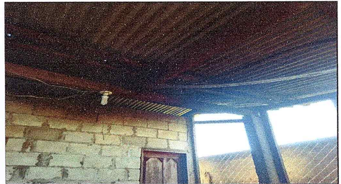
FOTO No. 8 LA ARMADURA DEL TECHO SE ENCUENTRA EN PRECARIAS CONDICIONES, ESO HACE QUE NO HA HABIDO BUEN AMBIENTE DENTRO Y FUERA PARA LAS COCINERAS.
