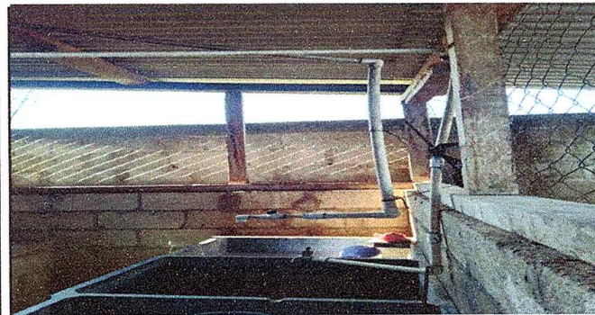
FOTO No. 5 PARTE DE LA COCINA SE NECESITA MEJORAR PARA QUE LOS ALUMNOS TOMEN SU REFACCIÓN CON UNA MAYOR COMODIDAD Y MENOS RIESGO.
